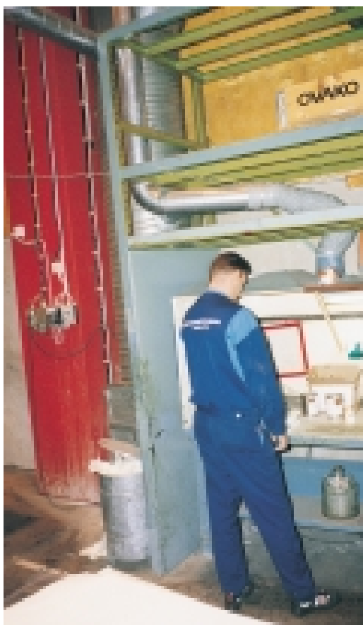
Box för blandning av epoxy. Genom att ha ett mindre, separat utsug för blandningsboxen behövde inte hela avdelningens utsug vara igång dygnet runt. Foto: ABB
