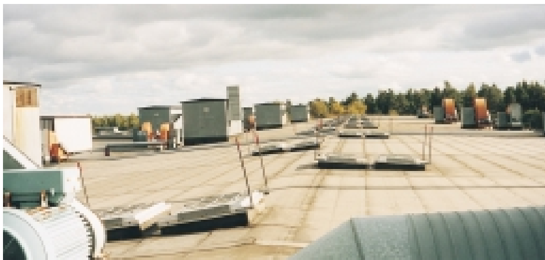
Utsugsfläktar och tilluftsaggregat på taket på verkstadsbyggnaden.
