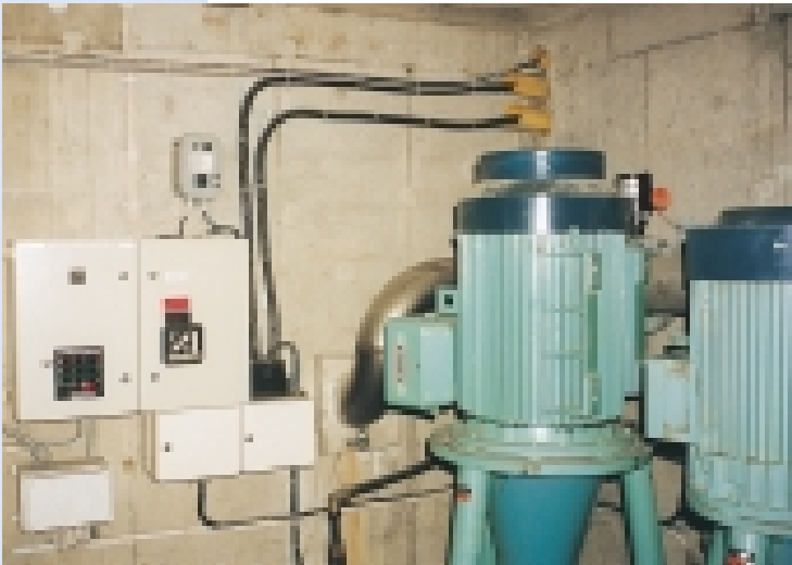
Reglering av processvattenpumpar. Placering: i grop några hundra meter från verkstaden.
