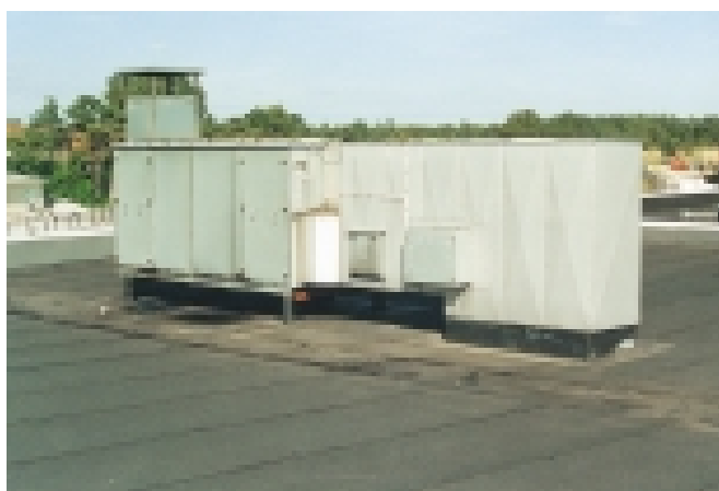
Ett av ventilationsaggregaten.
